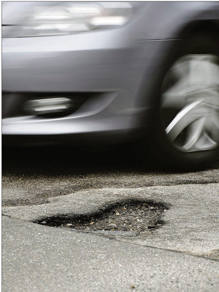
Schlaglöcher machen oft Schlagzeilen und jeder sieht sofort, wo es hakt.
