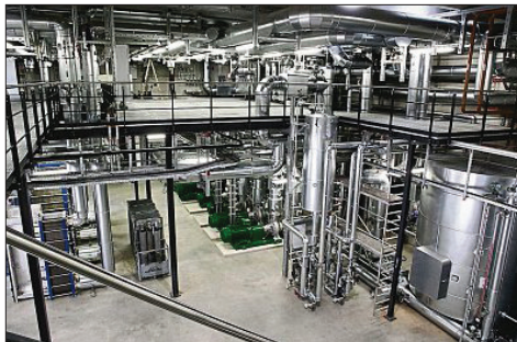
Das Heizwerk von innen.
