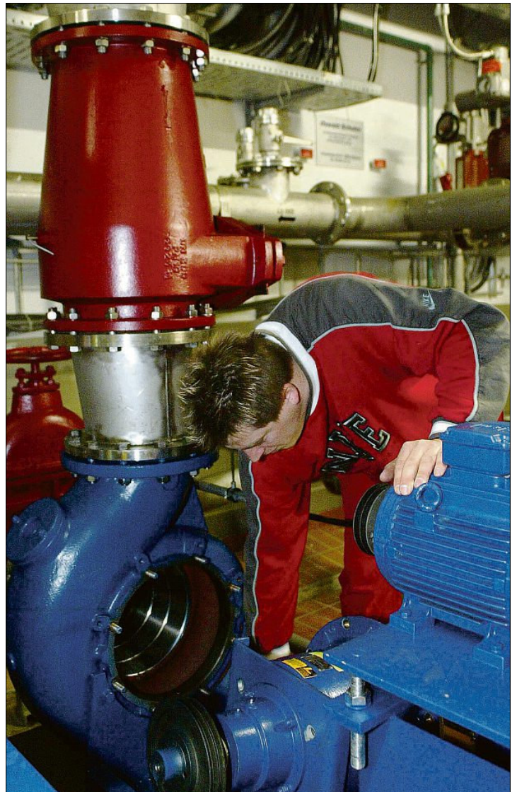
Ein Elektriker kontrolliert die Pumpen einer kommunalen Entwässerungsanlage.
