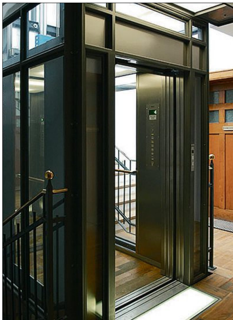
Aufzüge des Feldkirchener Unternehmens Riedl sind auf dem neuesten technologischen Stand. FOTO RIEDL
