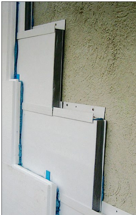
Sanierung mit Vakuumdämmung: Um großflächige Wände zu bestücken, werden mehrere Platten in unterschiedlichen Formaten nebeneinander platziert. Die Paneele werden in einem Schienensystem verlegt und annähernd wärmebrückenfrei aneinander gereiht.
