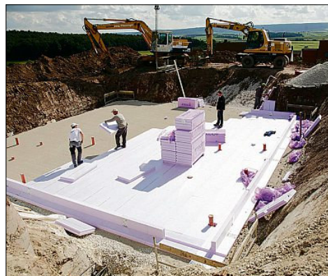
Durch die aufeinander abgestimmten Elemente geht die Verlegung des zum Patent angemeldeten Stecksystems, das Dämmung und Schalung in einem ist, rasch voran.
