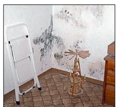
Schimmelpilzbefall in den eigenen vier Wänden ist nicht nur lästig, sondern kann zur Gesundheitsgefahr werden. FOTO B52
