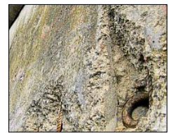
Bröckelnder Beton. FOTO INSTANDESETZUNG VON BETONBAUWERKEN E.V.
