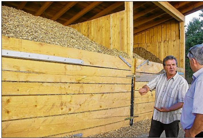
Willi Locker zeigt den Holzbunker für sein Blockheizkraftwerk.
