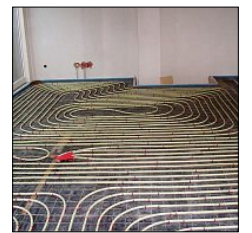
Die Fußbodenheizung als integraler Bestandteil des Hohlbodens.
