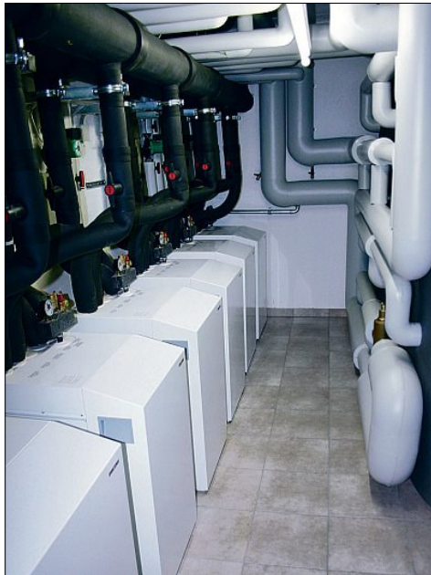
Sechs Wärmepumpen beheizen den Hotelkomplex, drei weitere das Wohnhaus. FOTO STIEBEL ELTRON
