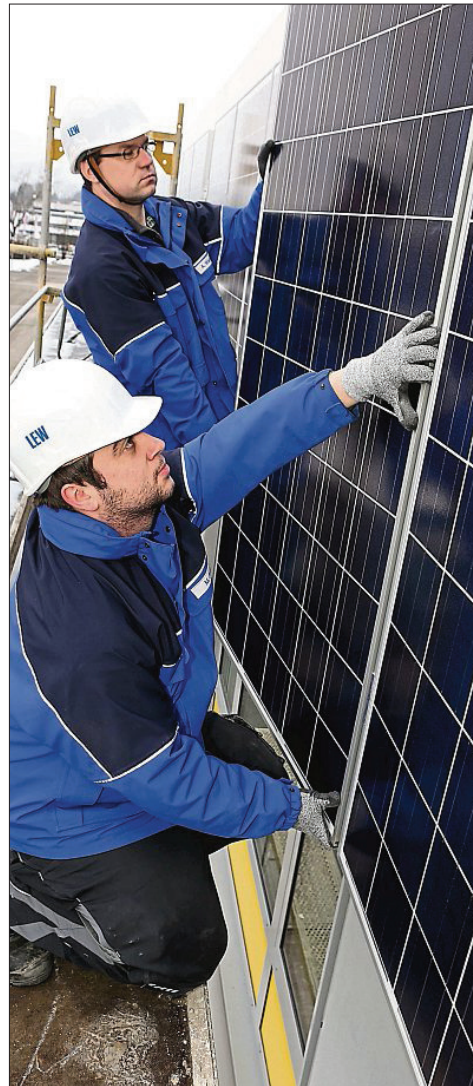
Vor Kurzem schlossen die Lechwerke die Arbeiten an der Fassade der Betriebshallen am Standort Stuttgarter Straße ab. FOTO LEW
